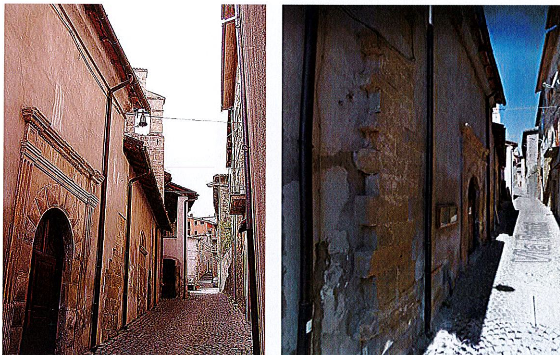
Fig. 6-7_Fronte su Via Roma della Chiesa e discontinuità muraria ai lati dell'ingresso principale (pre-sisma).
